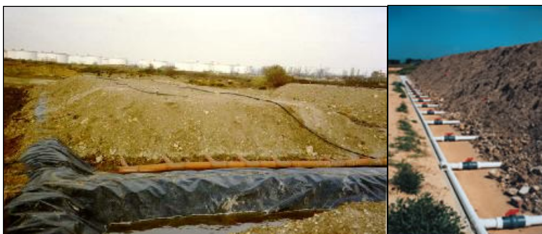
Figura 3.4 – esempi di disposizione delle tubature di aerazione della biopila con e senza sponde perimetrali ( http://emaq.aeat.com e www.flindersbioremediation.com ).
