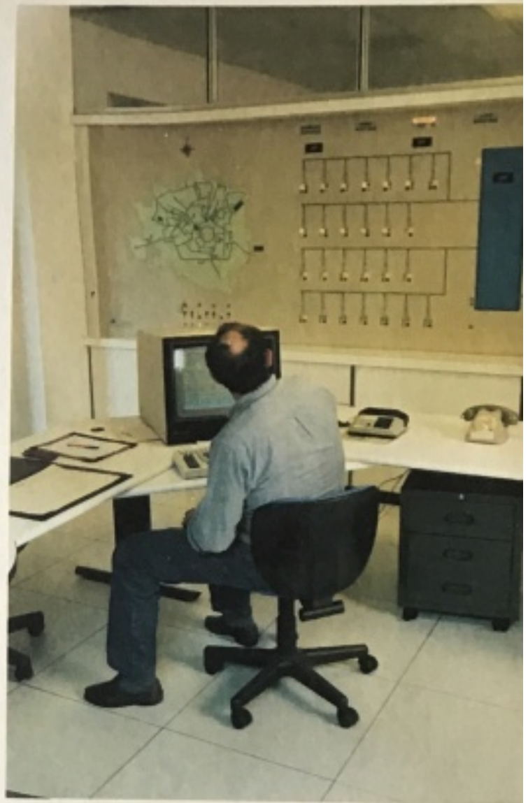
Acquedotto di Milano Centrale S. Siro Pannello di controllo
