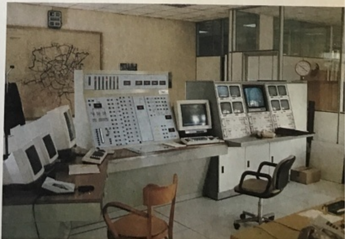
Acquedotto di Milano Centrale Anfossi Pannello di controllo
